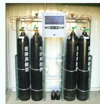
ボンベ供給設備例
