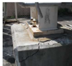
(写真12. CE基礎に亀裂)
