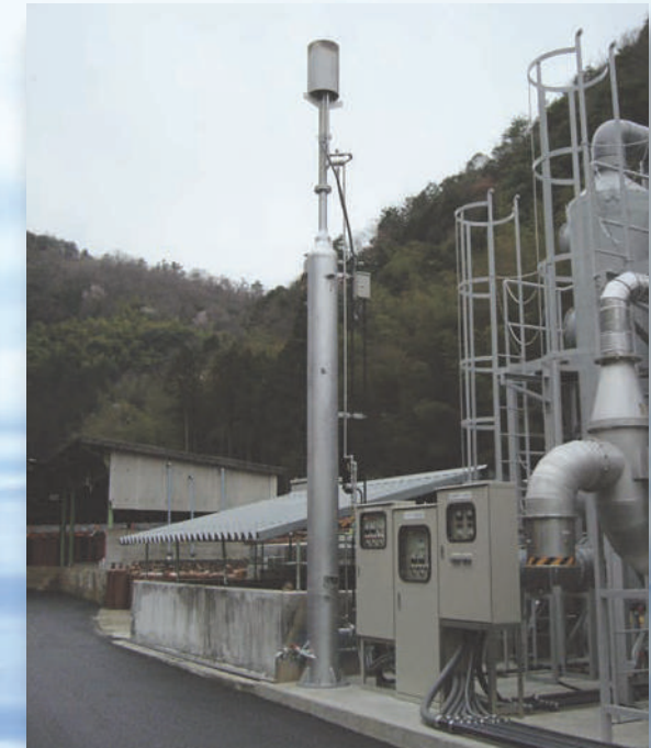
フレアスタック設備
