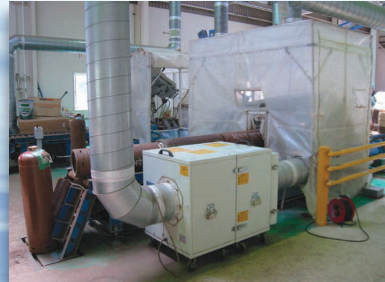
バンドソーマシン防塵カバー及び集塵排気設備
