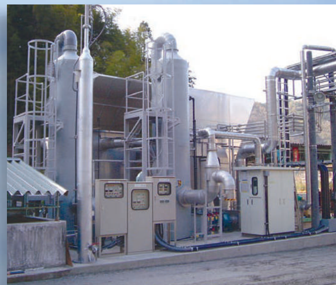
除害装置群: 燃焼除害装置・アルカリスクラバー・緊急除害装置
