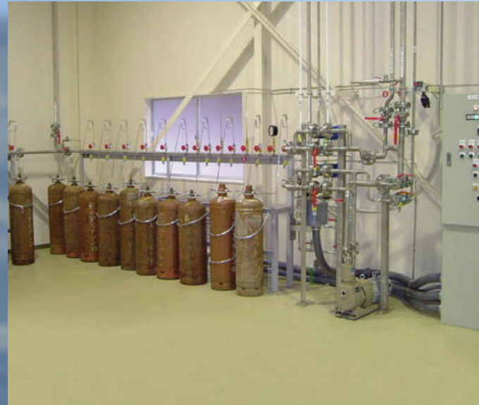
ガス回収設備 (AC20本立て集合装置)
