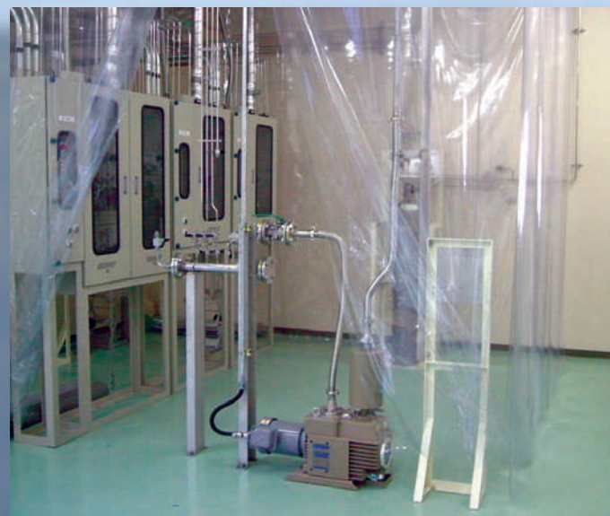
ガス回収架台 (3基)
