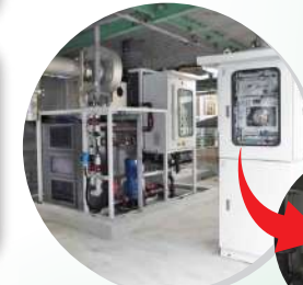
排ガス処理 燃焼除害
