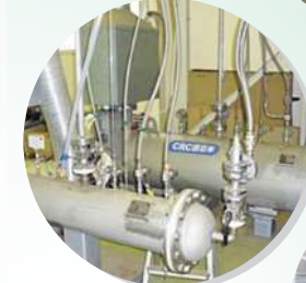
デバルバー (容器穿孔) 設備
