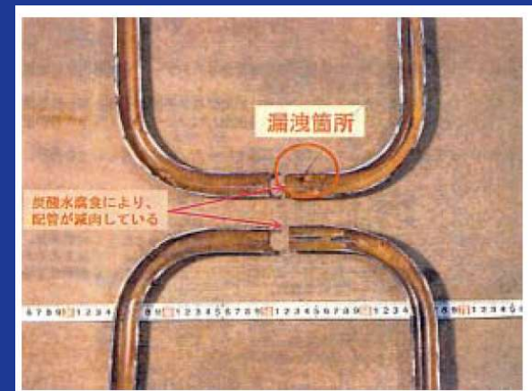
腐食した計装導圧配管
