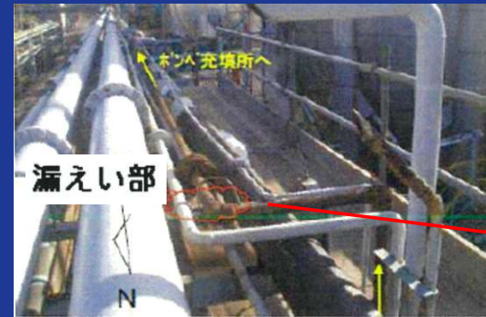
【配管ラック全景】
