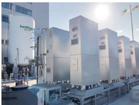
中央研究所に導入した純水素型燃料電池
