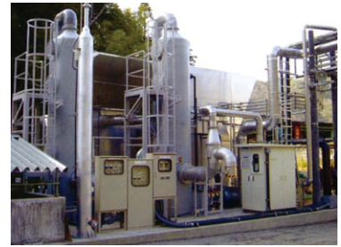
除害装置群：燃焼除害装置・アルカリスクラバー・緊急除害装置
