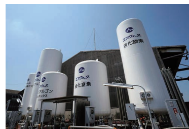
名古屋充填工場
