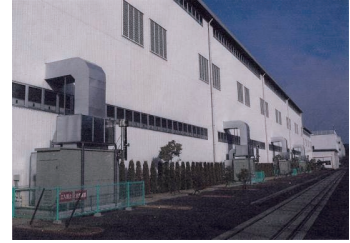
熱風循環式塗装乾燥設備
