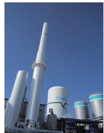
製造プラント外観
