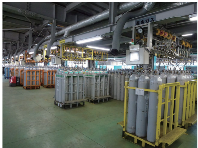
天井からの吊下げ型の充填架台
