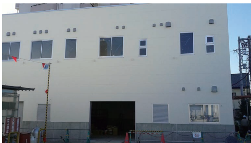
新設建屋設備等全景
