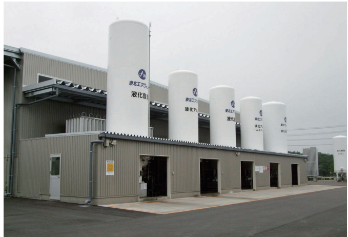
八戸ガスセンター外観
