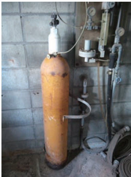
放置された塩素ガス容器
