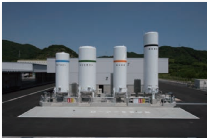
一般ガス充填棟
