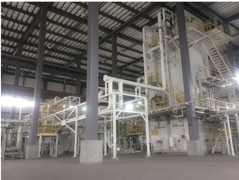
苫小牧工場 空気液化分離プラント
