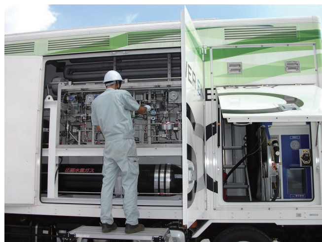
水素ステーションの日常点検の様子
