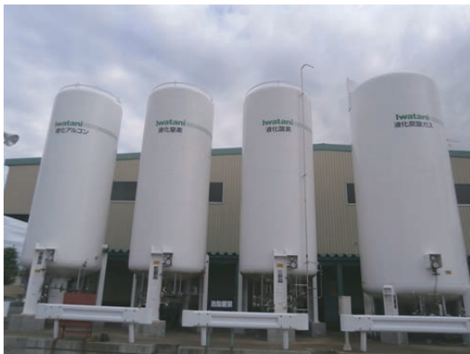
各種ガスの貯槽
