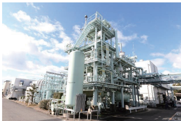
液化炭酸ガス製造プラント
