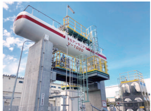
アンモニア混焼用液化アンモニア貯槽
