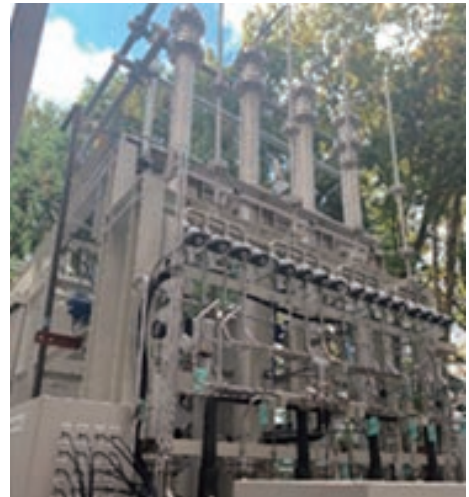
ごみ焼却場の排ガスからCO 2 を回収
