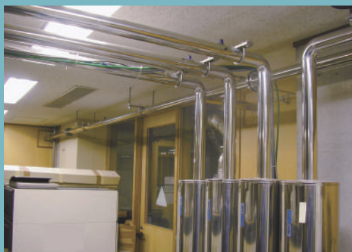
積層断熱真空配管
